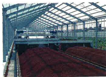
攪拌発酵処理施設による堆肥化
