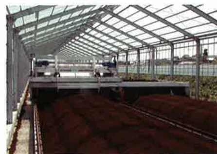
攪拌発酵処理施設による堆肥化
