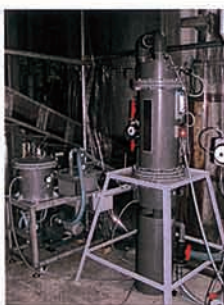
接続装置と一次脱臭施設
